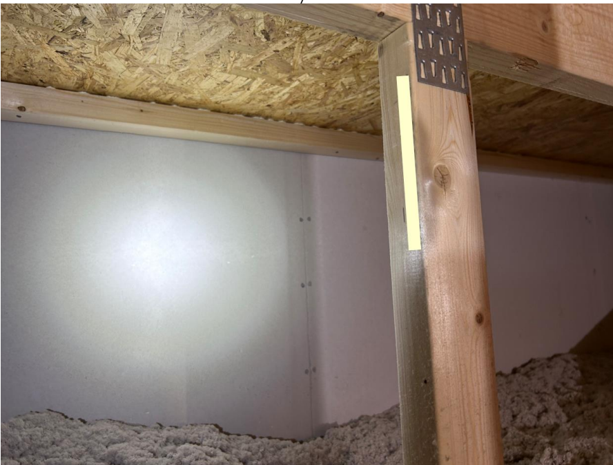
Kuva 2. Huoneistojen välisen seinän ja vesikaton liitos on tiivistetty. Mikä hidastaa savun ja tulen leviämistä naapurin puoleiselle ullakolle. Kuva: Juhan-Petteri Laakso / SPPL.
